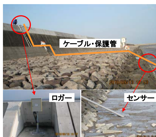
写真-1 水位計の設置状況（④大擲）
